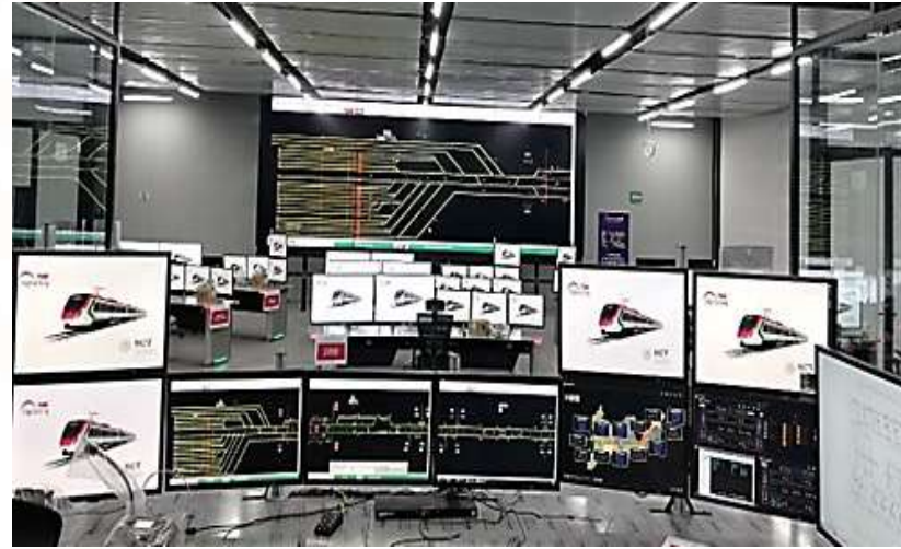
Puesta en marcha de sistemas desde el Centro de Control de Operaciones
